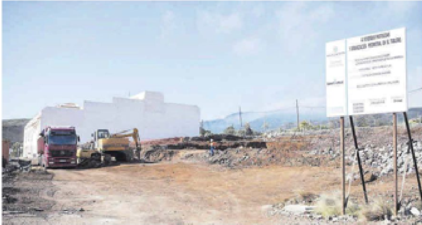
Un instante de los trabajos para la construcción de 44 viviendas protegidas en la localidad de El Taberno, en Santa Cruz de Tenerife. | CARLOS V. LAUREANO
