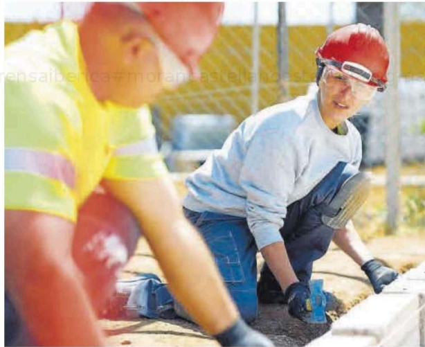
Cualificación profesional en La fundación Laboral de la construcción de Las Palmas. | LP/DLP
