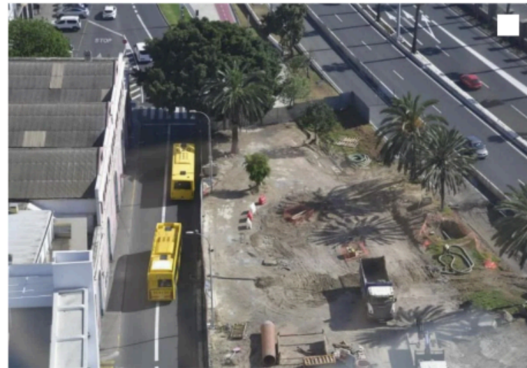
Obras de la Metroguagua en la zona de Santa Catalina. Arcadio Suárez
